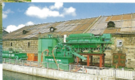
処理機械設置状況
