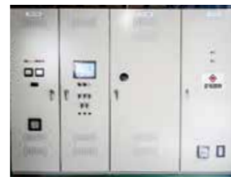
系統連系盤 (発電制御、昇圧トランス含む)
